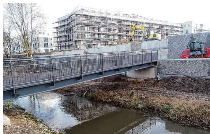
Noch sind die Bagger da: Vier Meter Höhenunterschied müssen Wege zur Brücke über eine Rampe sowie Treppen ausgleichen Foto: Haas
